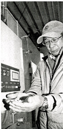
木質ペレットとボイラーを紹介する小林さん
